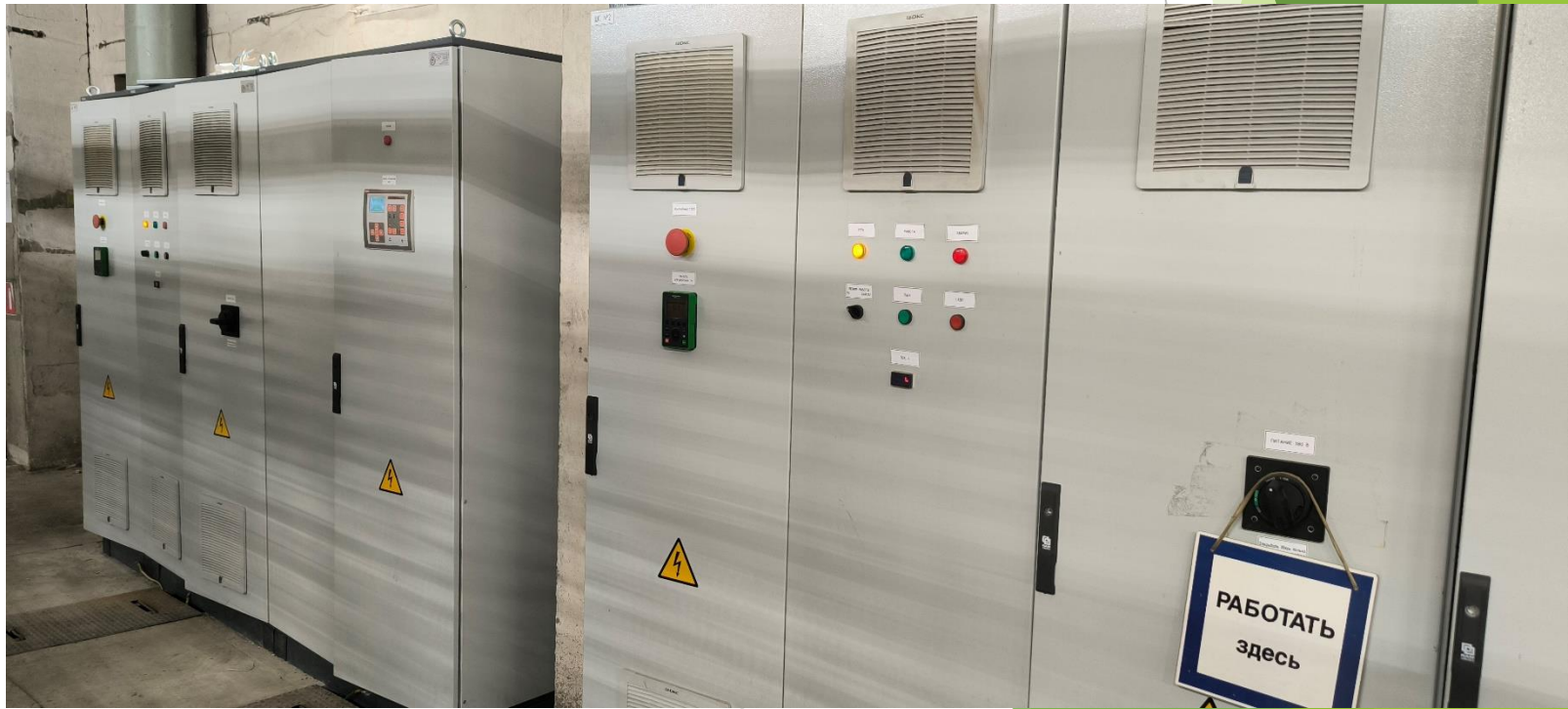
Шкафы автоматизации на объекте заказчика
